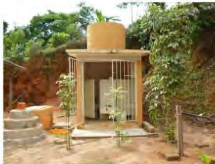
Imagen 1.- Talud sin protección en el plantel.
