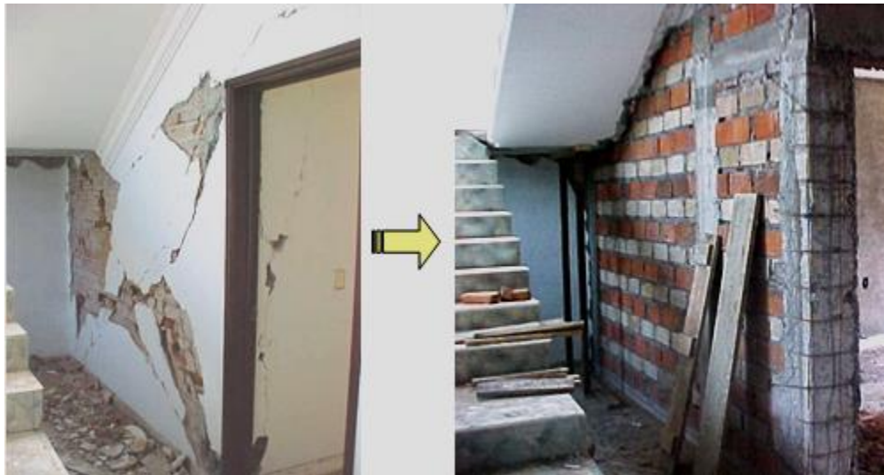
Ilustración 15. Muro de mampostería dañado y reemplazado por un nuevo muro. Fuente: Rafael Martín del Campo, 2018.
