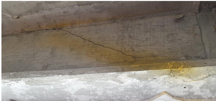
Ilustración 6. Identificación y descubrimiento de la grieta de acabados adyacentes. Fuente: Rubén Bautista, 2019.
