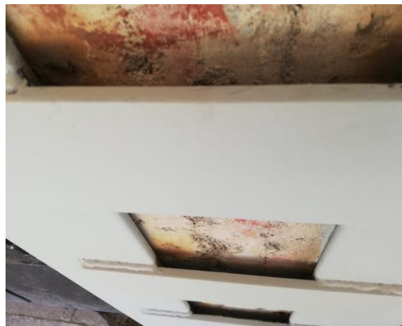
Ilustración 23. Práctica no permitida: encamisado metálico sin mortero entre los elementos de acero y el miembro de concreto. Fuente: Archivo personal de Víctor Cruz, 2019.
