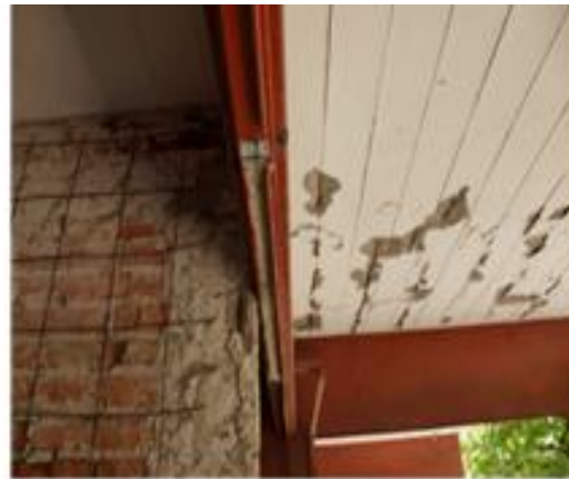
b) Práctica incorrecta de cortar el armado del encamisado en el borde, sin darle continuidad alrededor de él
