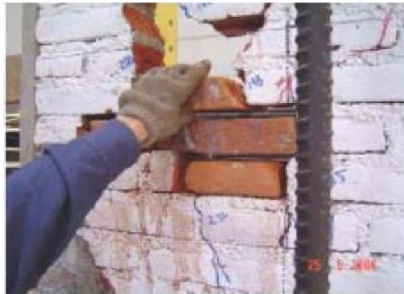
Ilustración 55. Reemplazo de piezas aplastadas. Fuente: Flores et al., 2004
