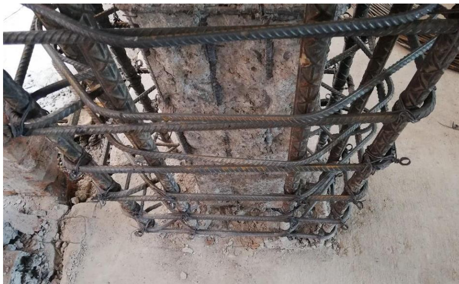
Ilustración 14. Encamisado de columna con estribos con dobleces a 135 grados y con refuerzo longitudinal anclado a la cimentación. Fuente: Archivo personal de Víctor Cruz, 2019.
