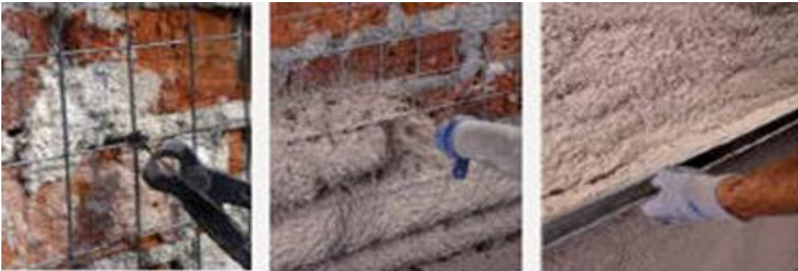
Ilustración 66. Colocación de mortero lanzado sobre la malla de alambres soldado. Fuente: CYPE Ingenieros, 2020.
