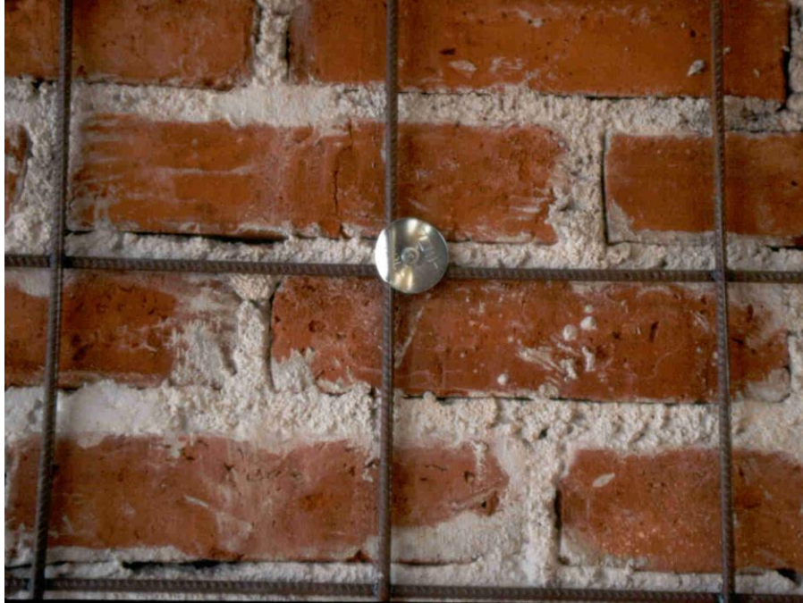
Ilustración 52. Conector instalado a través de carga explosiva de potencia controlada. Fuente: Archivo personal de Sergio Alcocer, 1996.
