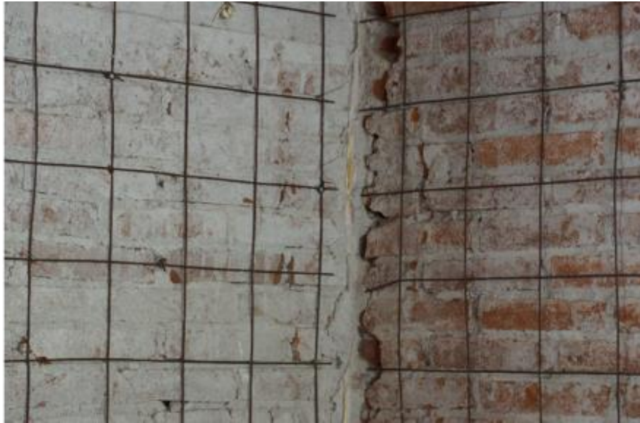
Ilustración 49. Práctica no permitida: falta de continuidad del refuerzo del encamisado en muros transversales.
