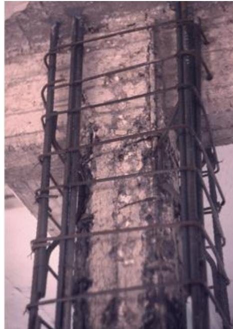
Ilustración 16. Práctica no permitida: soldadura entre aceros de refuerzo. Fuente: Vandoros y Dritsos, 2006.
