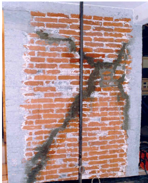
Ilustración 54. Reparación de grietas por rajueleo. Fuente: Archivo personal de Sergio Alcocer, 1994.
