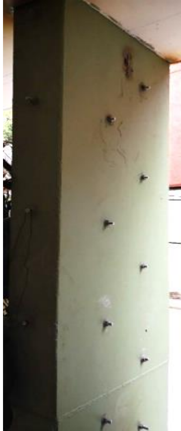
Ilustración 33. Distribución adecuada de conectores en encamisado de placas de acero. Fuente: Archivo personal de Rubén Bautista, 2019.
