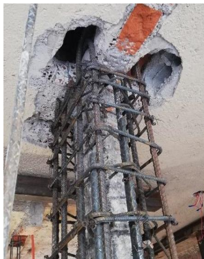
Ilustración 5. Columna encamisada con concreto de forma continua a través de las losas: Fuente: Archivo personal de Víctor Cruz, 2019
