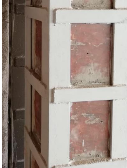
Ilustración 34. Mortero fluido sin contracción colocado entre las soleras y el concreto. Fuente: Archivo personal de Víctor Cruz, 2019.
