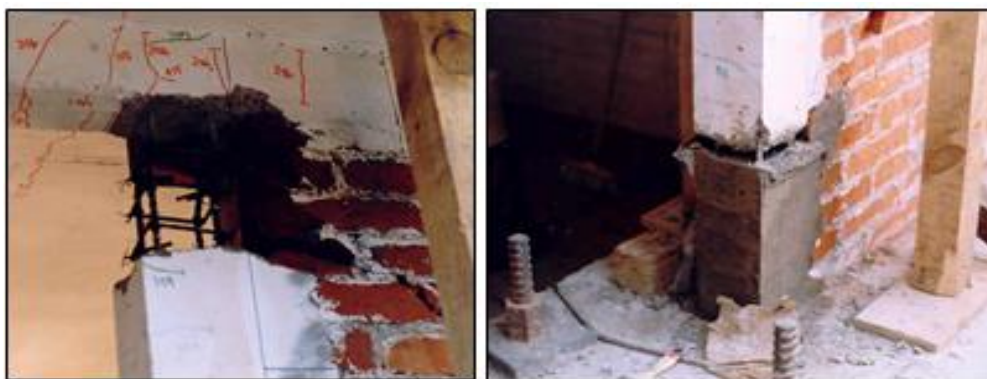
Ilustración 56. Reconstrucción de castillos dañados. Fuente: Archivo personal de Sergio Alcocer, 1994.
