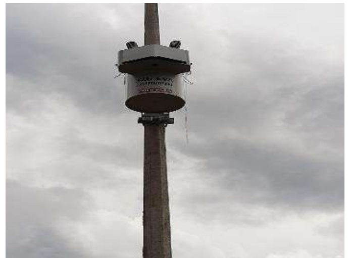
TRANSFORMADOR DE 37.5 KVA
