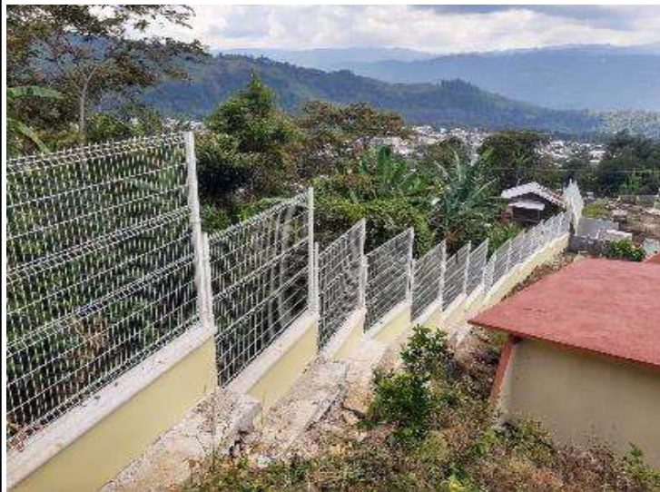
BARDA DE REJACERO
